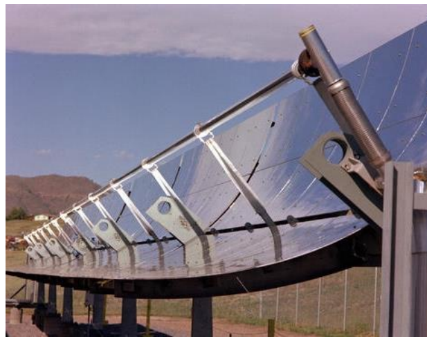
Figura 6: Centrale termodinamica a specchi parabolici lineari
